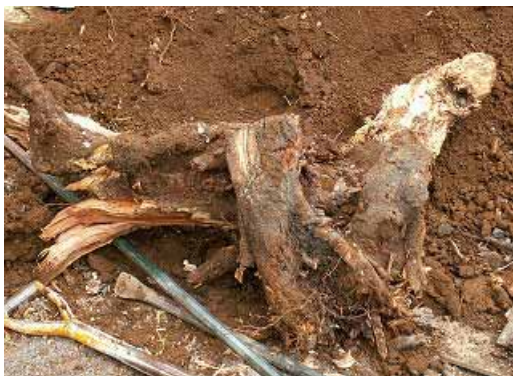
掘り上げられた腐った根 中央桜通り（C4） 平成19年3月5日
